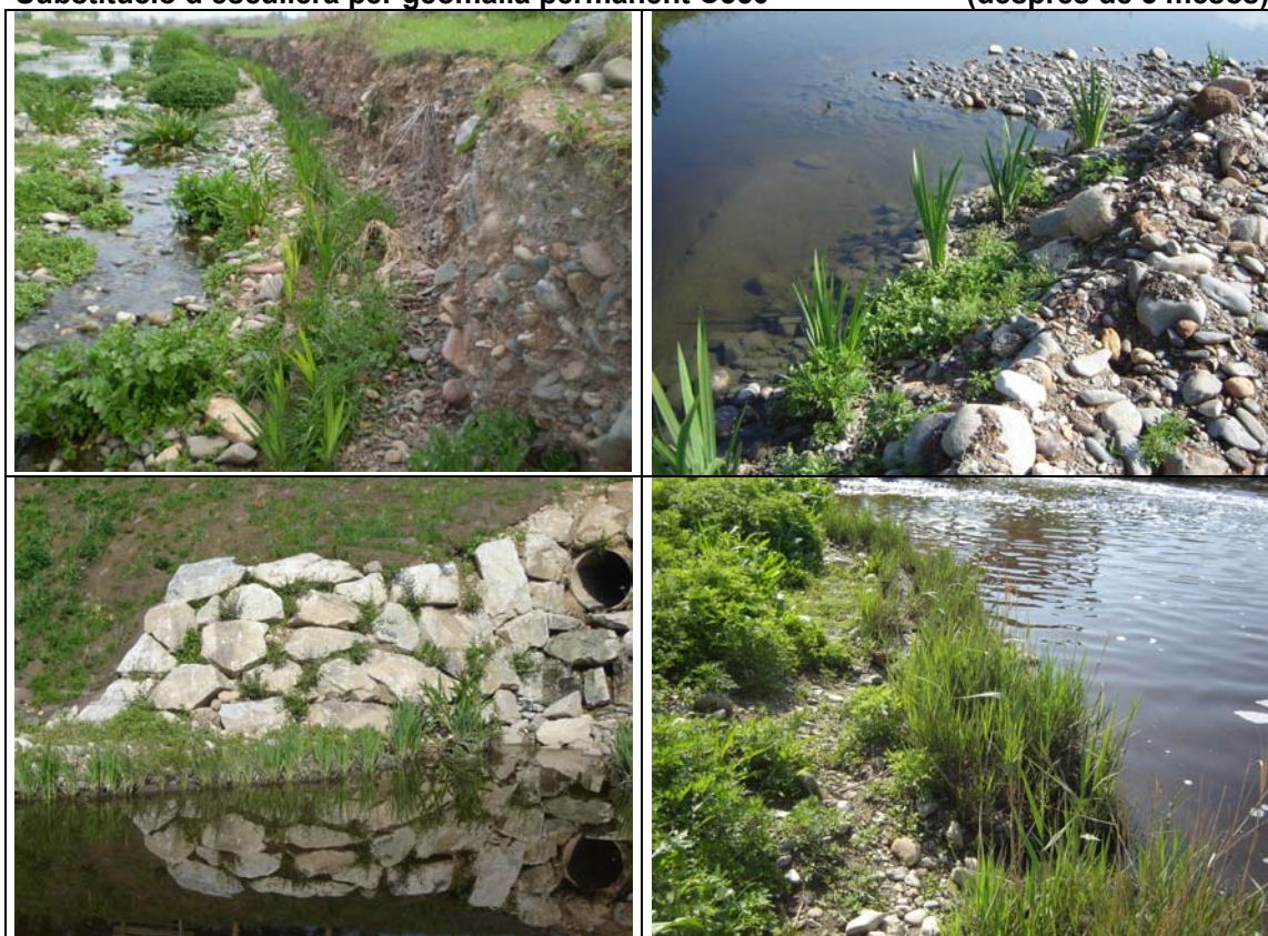
Fotos esquerra: Instal·lació de Fiber roll™ vegetat al peu del marge i de l'escullera, Fotos dreta, inferior: Plantació de Plant pallet™, superior: Plantació de Plant plug™
