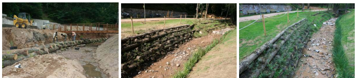
Durante la construcción de un entramado tipo Kriener y una vez finalizado
