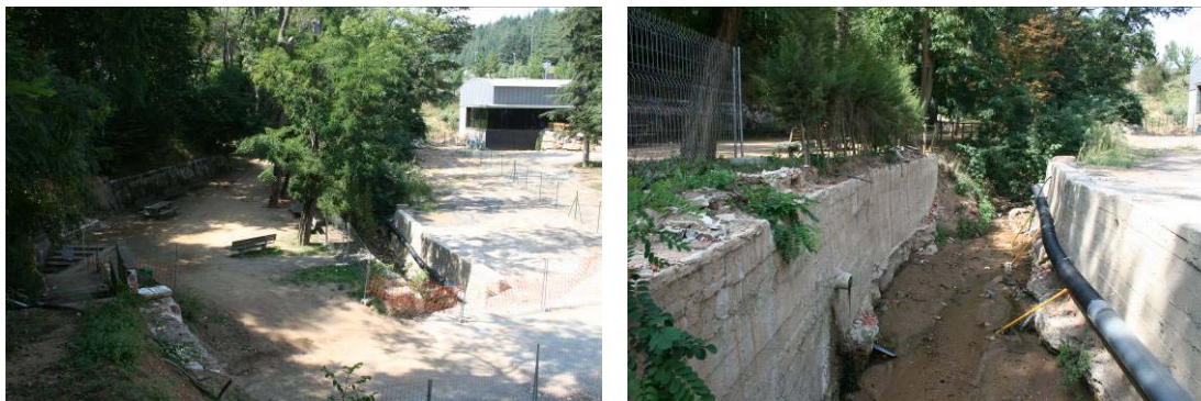
Imágenes de la zona antes de la intervención con el colector colgado del muro y una total degradación del espacio.
