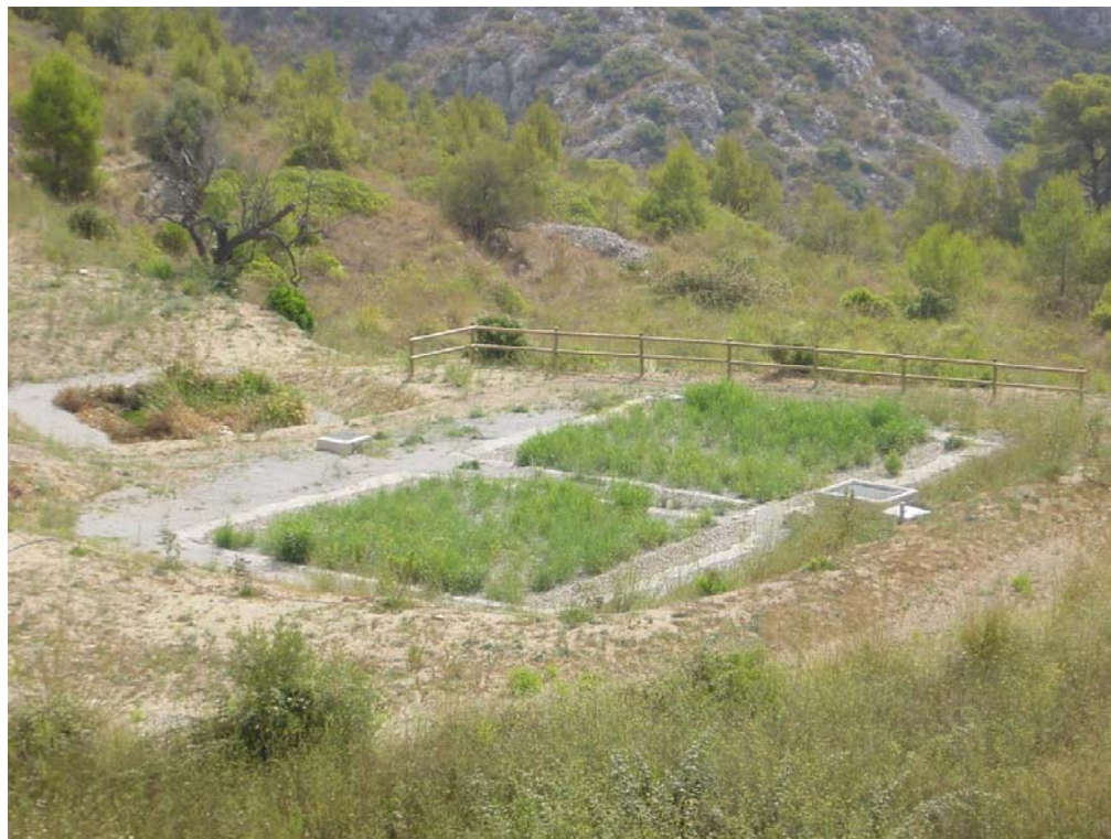
Vista general de la depuradora natural de Can Grau 2 meses después de la ejecución, en pleno funcionamiento.
