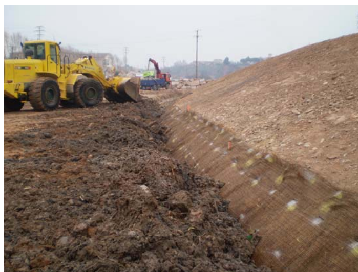
Instalación de los Rock roll™ (gavión flexible) con medios mecánicos en el fondo de la zanja, pisando la geomalla C350 de NAG. En la última foto se aprecia el relleno de la zanja.
