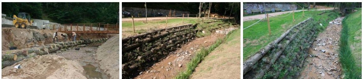
Durant la construcció d'un entramat tipus Krainer i un cop ja finalitzat
