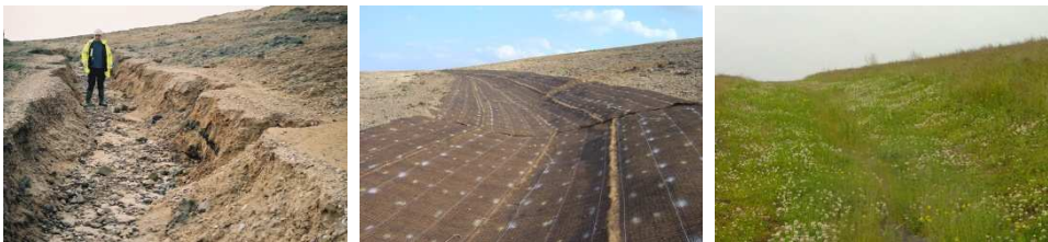
Canal de drenaje con geomalla permanente C350 Vmax
